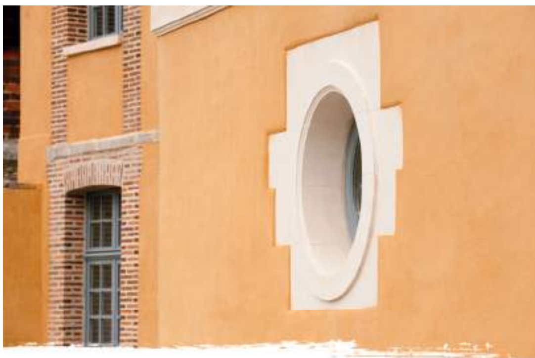
Enduits extérieurs, mortiers de chaux. Rénovation maison St Vincent de Paul, Joigny (89)
